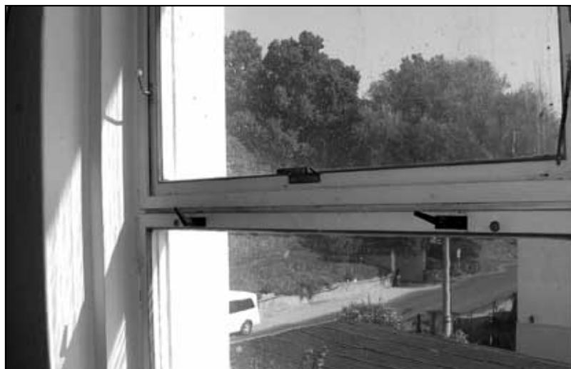
Stará okna už dosloužila.
